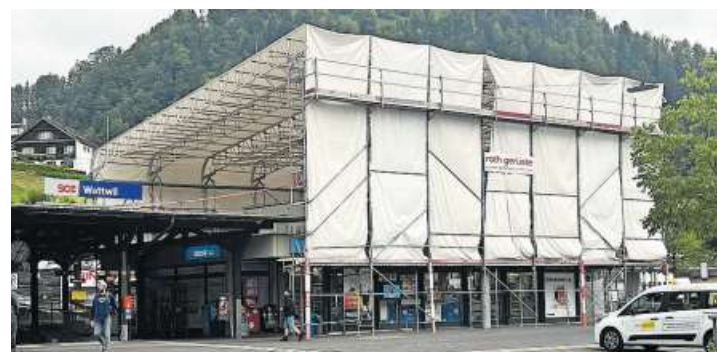
Das Flachdach des Kioskgebäudes beim Bahnhof Wattwil weist undichte Stellen auf und muss saniert werden. Bild: Simon Dudle
