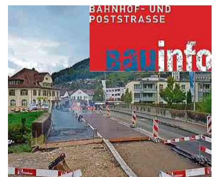
Auf der Postbrücke konnte auf der Westseite bereits der rote Gussasphalt eingebaut werden. zVg
